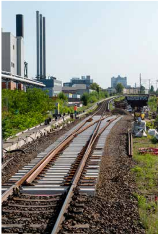
Frisch geschottert im Gleisbett: die neue Weiche am S-Bf Westhafen Richtung Hauptbahnhof
