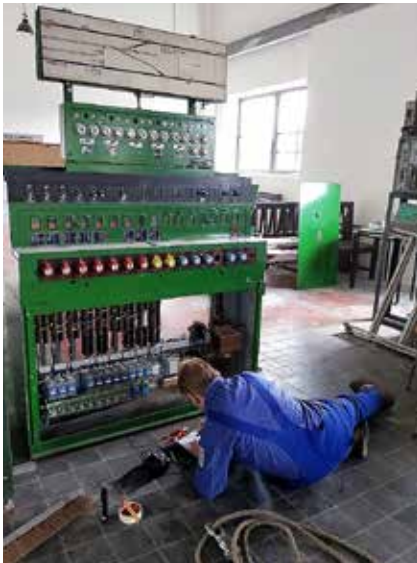
Ein elektromechanisches Stellwerk – modern und doch schon rund 100 Jahre alt.
