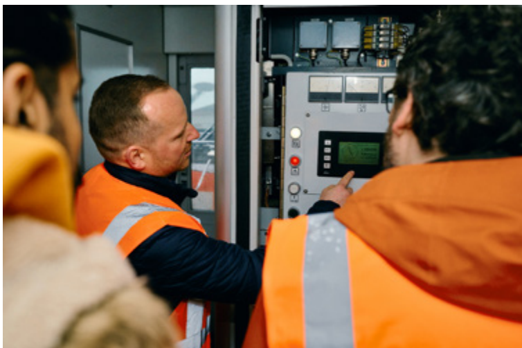
Trainer Tobias Bredow erläutert die einzelnen Bestandteile der Schaltschranktafel.
